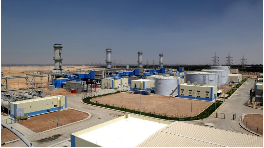
محطة كهرباء غرب أسيوط المركبة
